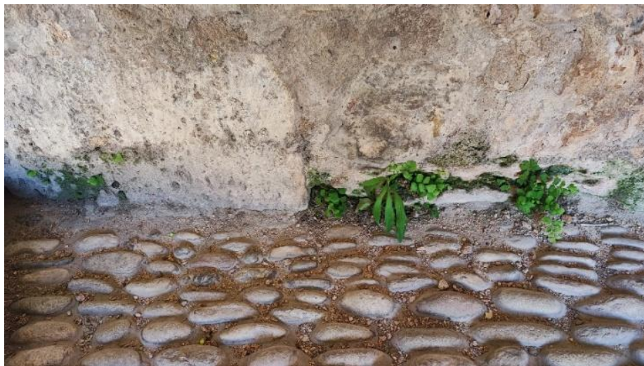
Distribución de Culantrillo de Pozo sobre paredes rezumantes en el interior de la puerta entrada principal del Castillo-Fortaleza.
